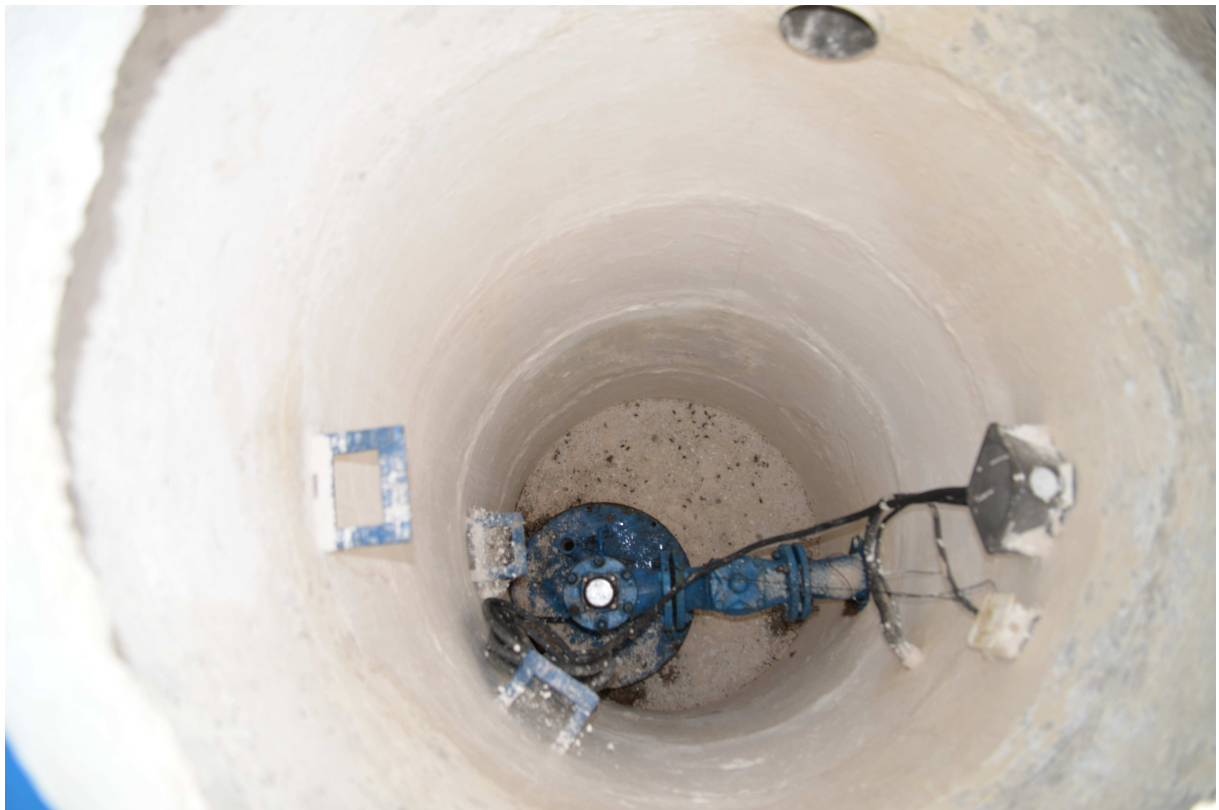
SUW Podlesiec - szyb studni ST 2
