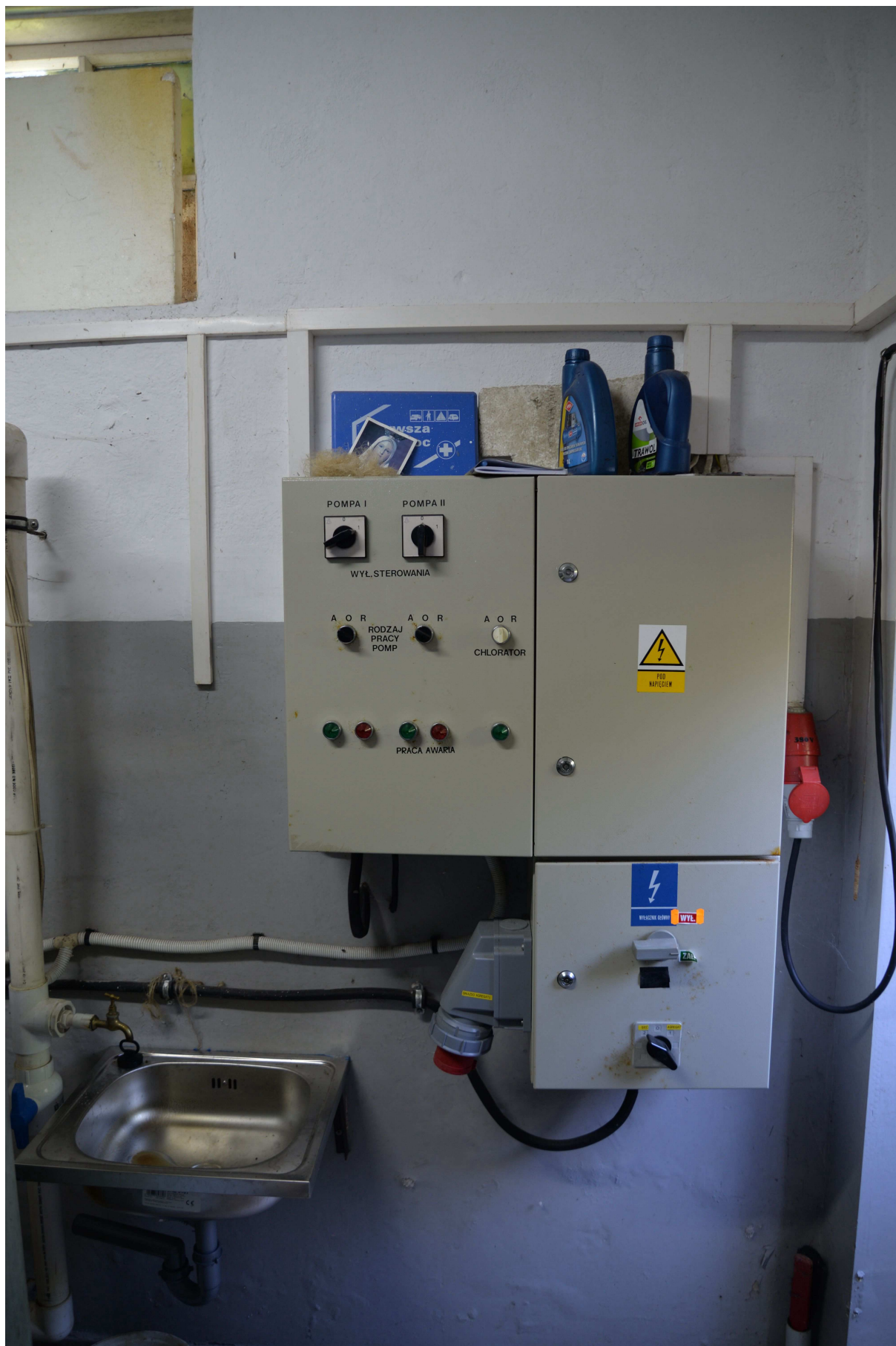
SUW Podlesiec - rozdzielnia energetyczna
