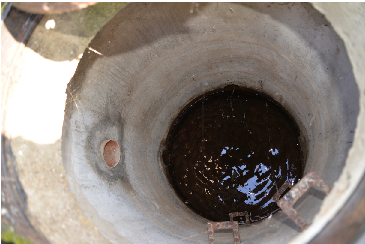
SUW Podlesiec - komora odstojnika wód popłucznych
