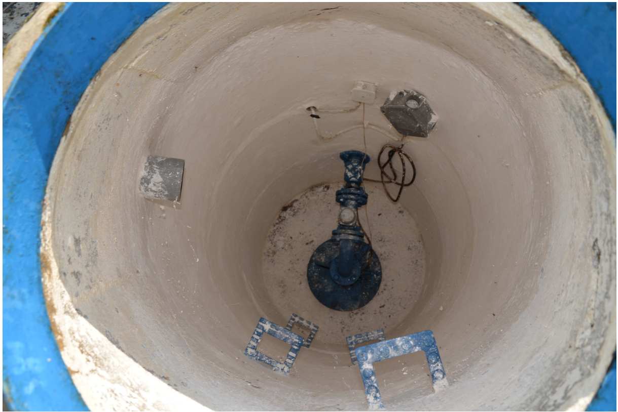
SUW Podlesiec - szyb studni ST 1
